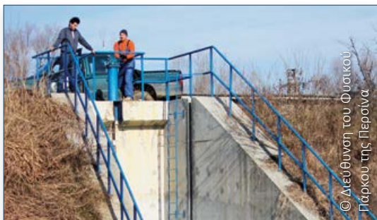
Υδροφράκτης εισροών στον αγωγό προστασίας στη νήσο Περίσα.
